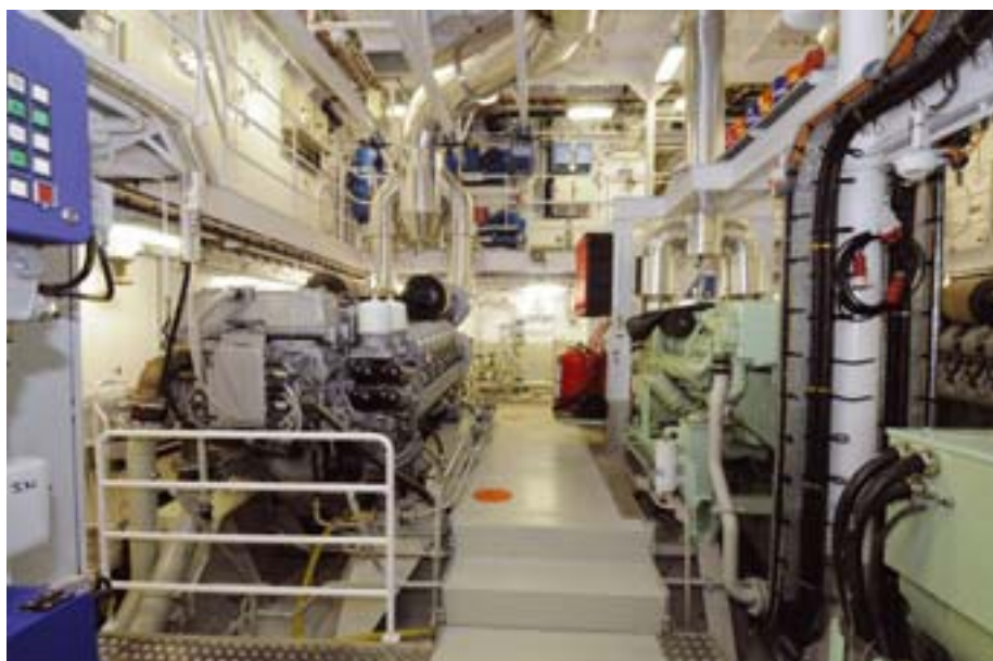
> Sala de máquinas. (Foto: ASTILLEROS GONDÁN.)
