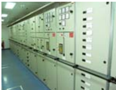
Panel de controles en la planta motriz.
