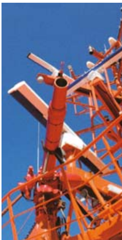
Equipos de comunicación y lucha contra incendios en el BS "Don Inda".
