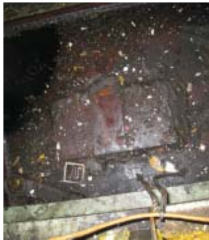
▲ Pallette en grieta bajo el motor auxiliar de babor.
